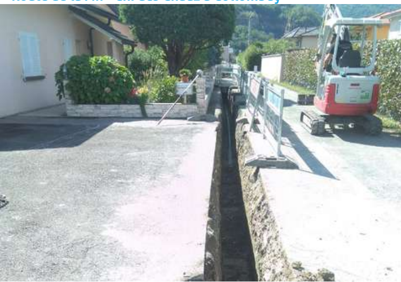
Route de la Fin - Ch. des Chauz à Collombey
